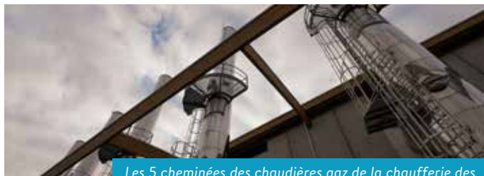
Les 5 cheminées des chaudières gaz de la chaufferie des Linandes à Cergy. Article extrait du webzine 13 COMME UNE
